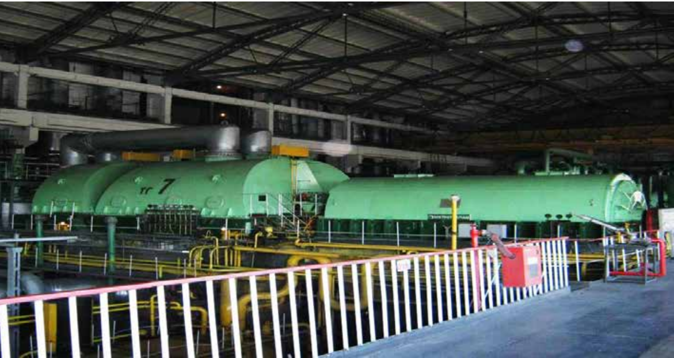
Реконструированный энергоблок № 7 Новочеркасской ГРЭС
